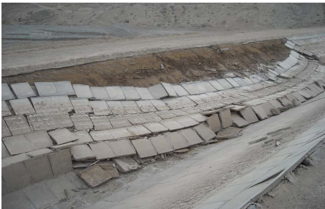
渠道阴面滑坡
