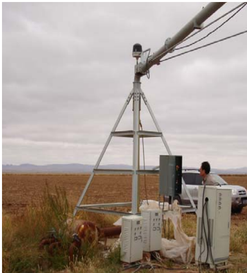
图 7：四井通过汇流罐向机组供水
