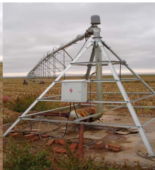
图 6：三井通过汇流罐向机组供水
