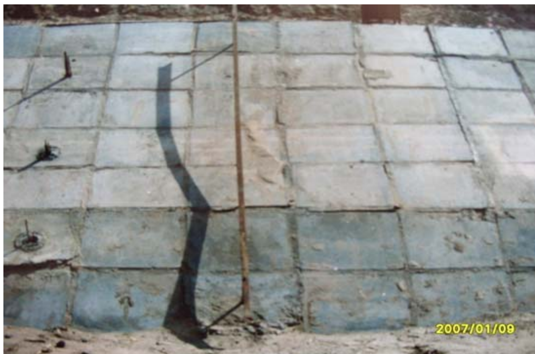
图 4 永刚分干渠未采取保温措施第一个冻融周期的冻胀情况
