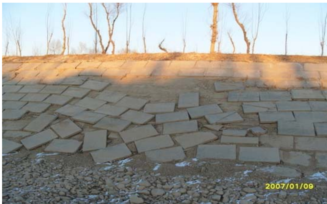
图 2 杨家和干渠未采取保温措施的试验段冻胀破坏情况
