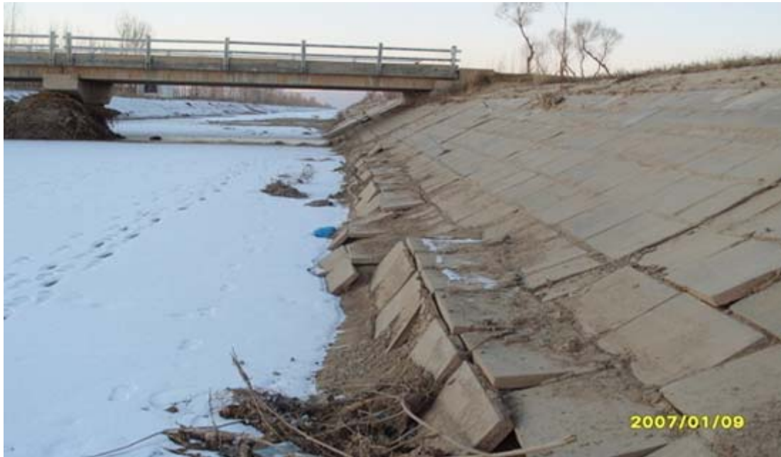
图 1 杨家和干渠未采取保温措施的试验段冻胀破坏情况
