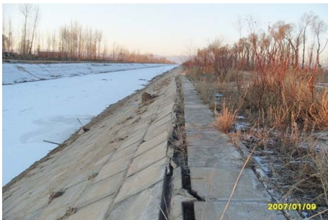
图 3 杨家和干渠未采取保温措施的部分试验段坡面已整体下滑
