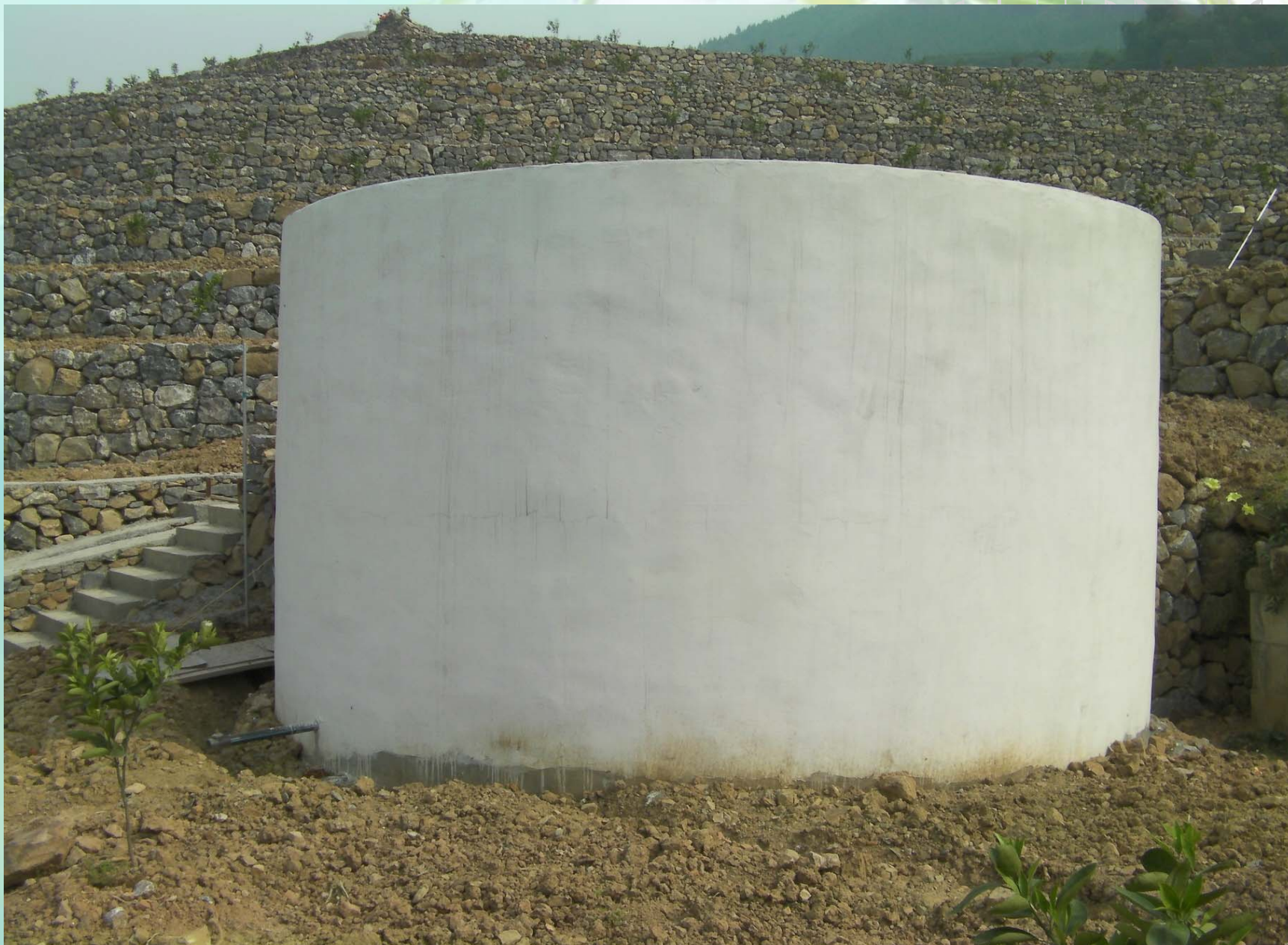
集雨池——用于收集雨水或者储存地下水，为微润灌溉系统提供水源。
