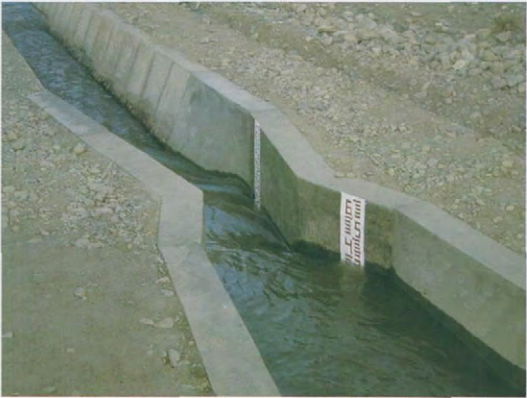
白银市靖远县渠道量水工程
