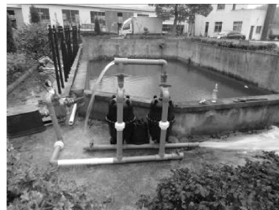
图 5 第一过滤设备反冲洗和第二过滤设备正常工作状态
