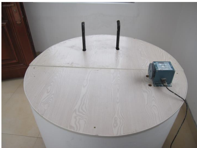
水位计安装平台
