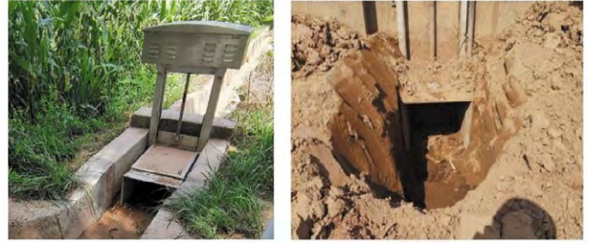
图5 田间进水口泥沙淤积现状
