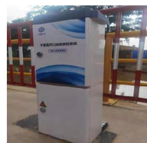
图3 自动控制闸门(改造)
